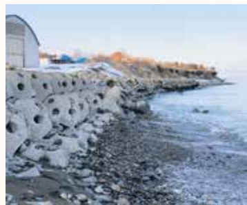
崎無異地区海岸の状況
