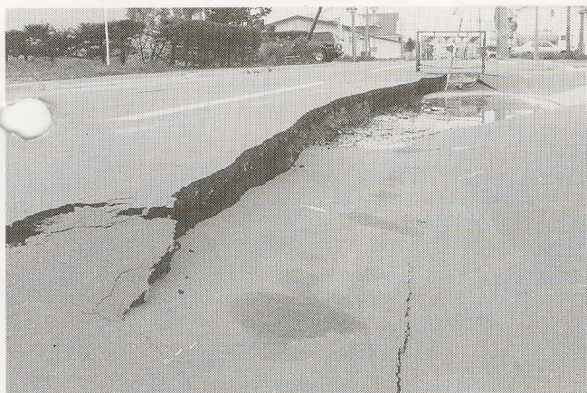
液状化現象により道路が陥没 （漁民団地通り）
