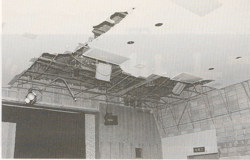
天井と壁が破損（標津漁協・3F大ホール）
