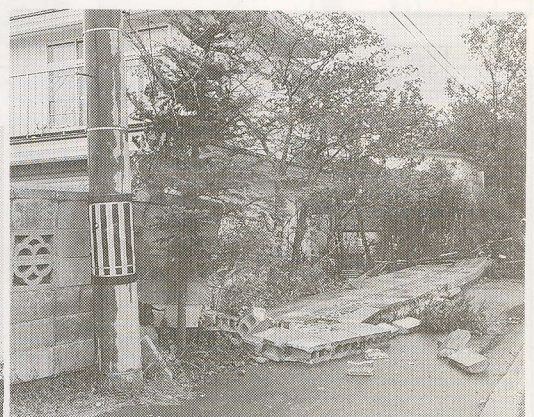
ブロックの塀が倒壊（弥栄町）
