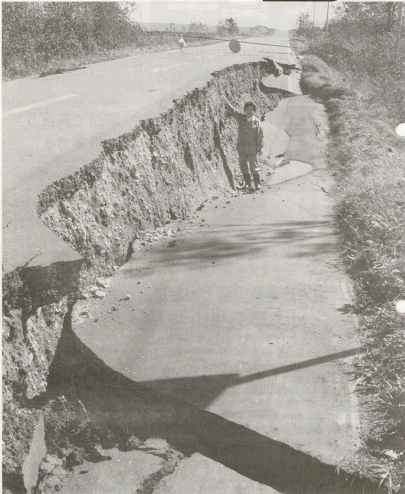
地震による道路崩壊（町道茶志骨西7線）
