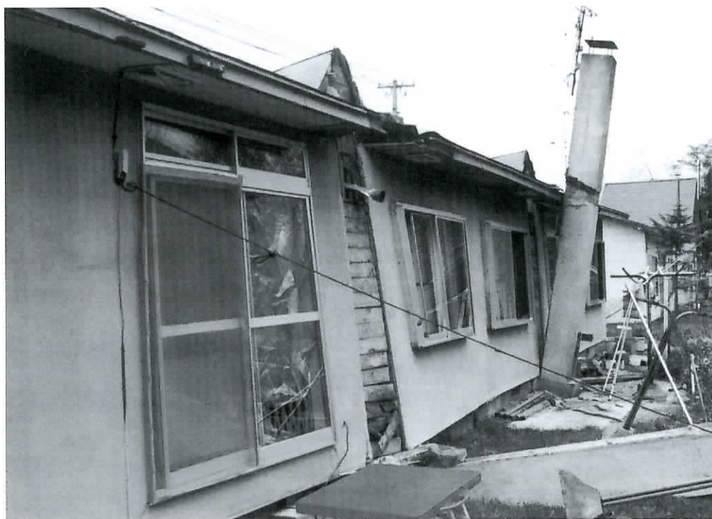
平成六年十月四日、北海道東方沖地震で集合煙突が倒壊、床や壁も破損した住宅(標津市街)
