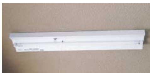
【役場庁舎に導入した蛍光灯】
