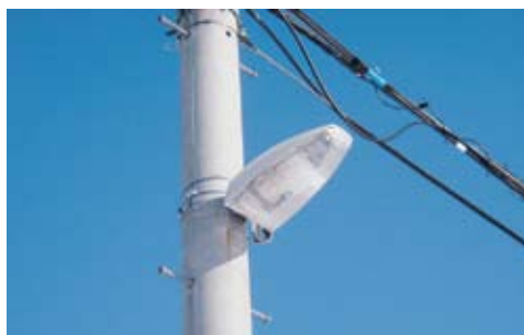
【町内に導入した防犯灯】
