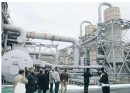
八丁原地熱発電所（大分県）
