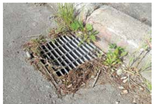
グレーチングの例 (上:きれいな状態、下:やや枯れ葉が堆積した状態)
