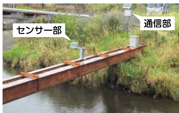
危機管理型水位計の状況
